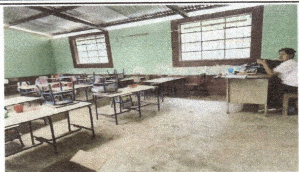
Foto 7: Piso de aula 1 en mal estado (modulo 1) necesita ser reemplado
