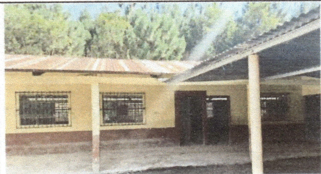
Foto 1: Laminas del modulo 1 en mal estado que necesitan ser sustituidas, pintura exterior dañada
