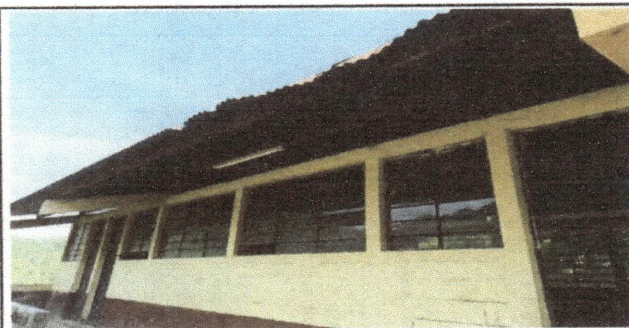
Foto 3: Laminas y estructura de techo en pesimas condiciones (modulo 2)
