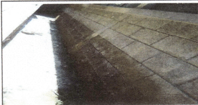
Foto 9: paredes dañadas que necesitan ser remozadas (modulo 2)
