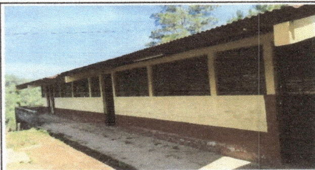
Foto 2: Modulo 2 laminas y estructura de techo en mal estado, vidrios quebrados y pintura exterior dañada
