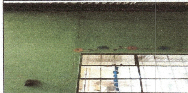
Foto 12: Sistema eléctrico deteriorado que necesita ser sustituido
